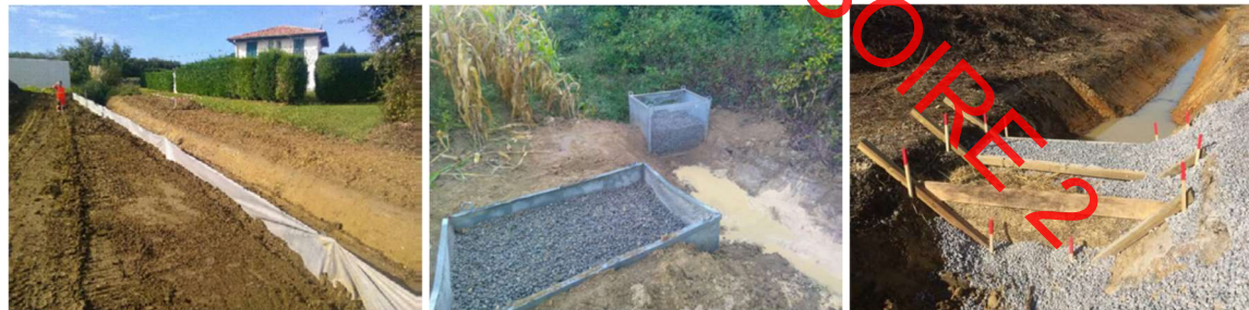
Exemples de systèmes de filtration sur un chantier de construction (Source : Simethis)
