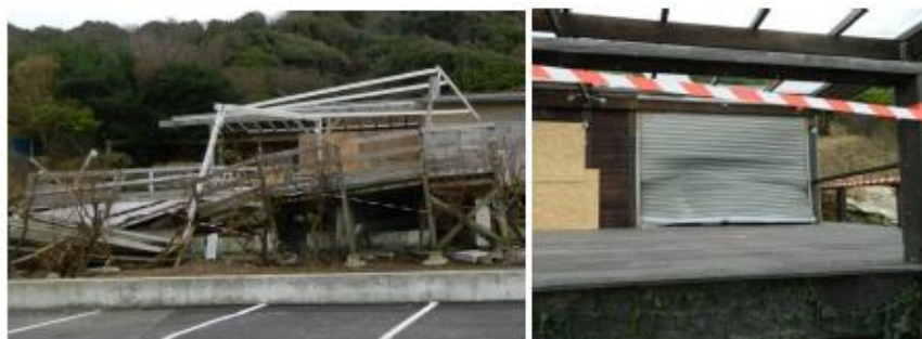
Figure 28 - Destruction des terrasses et enfoncement des portes métalliques des restaurants de la jetée des Alcyons (Guéthary, BRGM, 09/01/2014).
